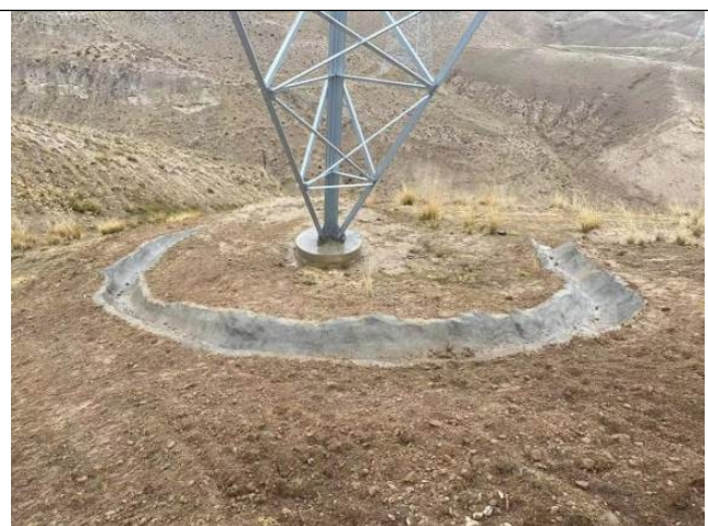
塔基截排水沟
