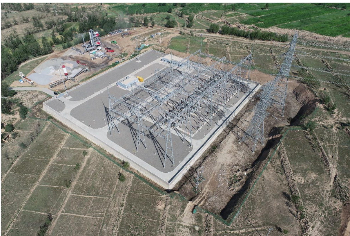
小寨 330kV 开关站 (2021 年 8 月 5 日)
