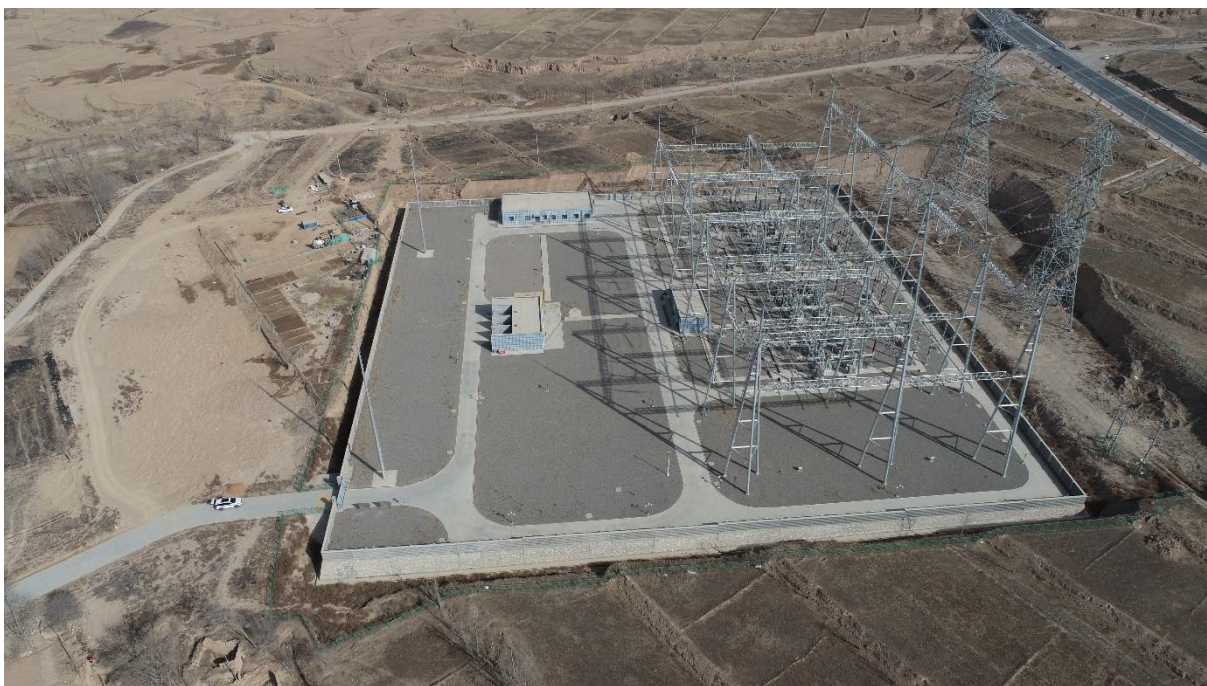
小寨 330kV 开关站 (2021 年 3 月 22 日)
