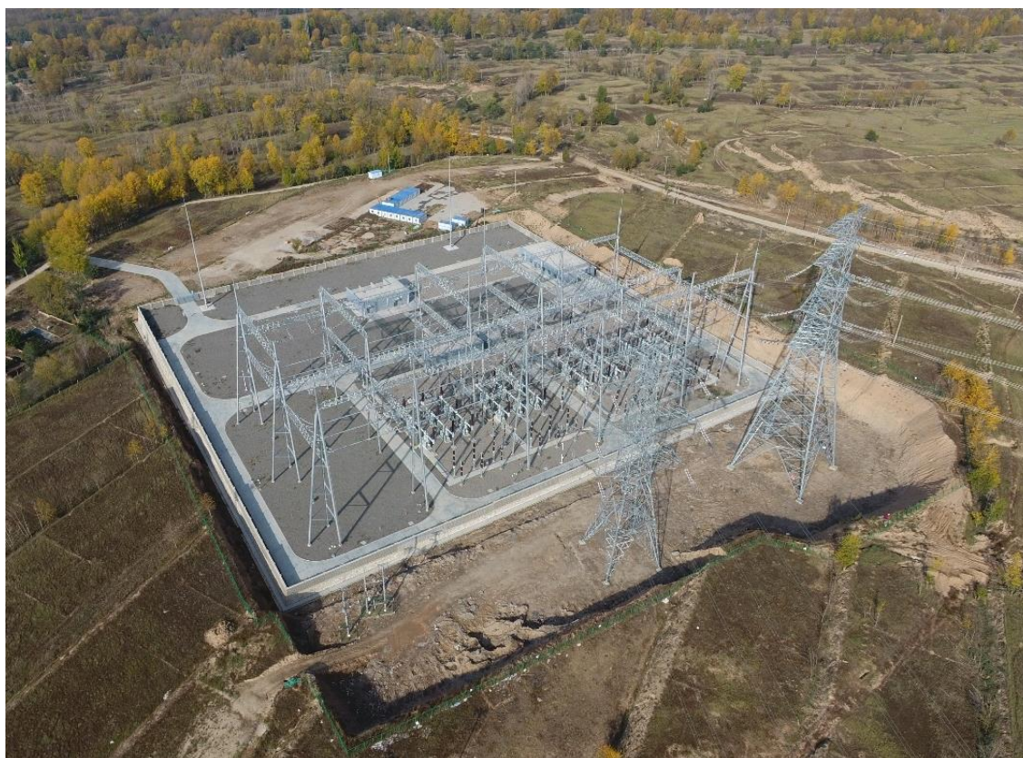
小寨 330kV 开关站 (2019 年 10 月 19 日)
