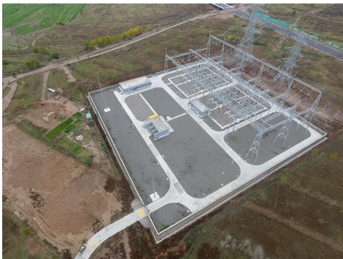
小寨 330kV 开关站 (2020 年 9 月 28 日)
