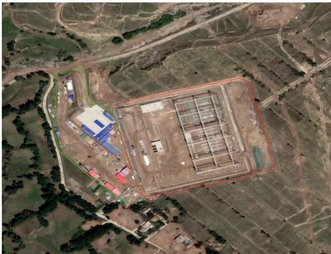
小寨 330kV 开关站 (2018 年 7 月 11 日)
