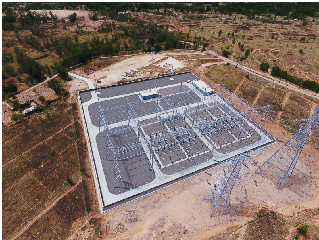
小寨 330kV 开关站 (2020 年 5 月 10 日)
