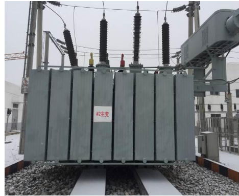
2#变压器及油坑
