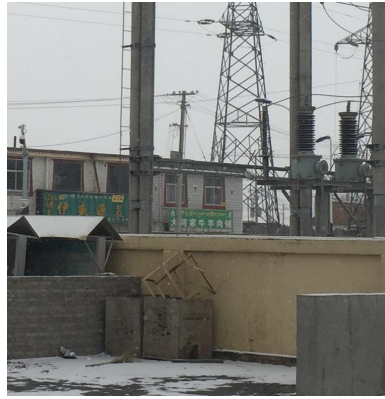
变电站垃圾收集设施
